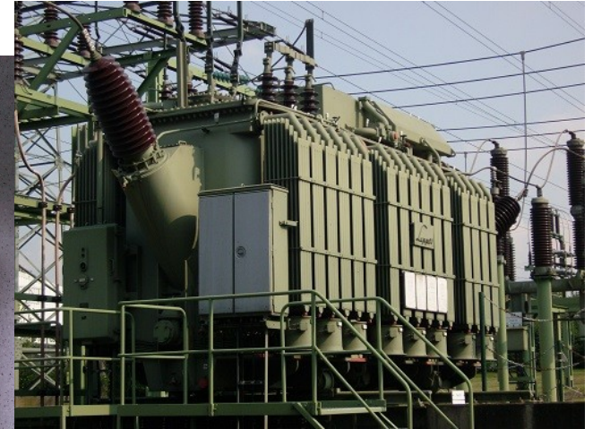
Hochspannungstrafo ca. 100 MVA
